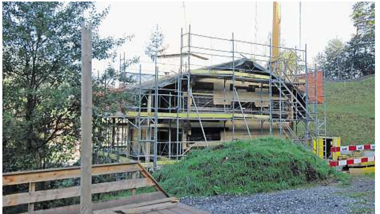
Die Bauarbeiten am Niederösthaus kommen voran. Das Dach ist da, die Finanzierung aber noch nicht restlos unter Dach. Bild Andreas Seeholzer
